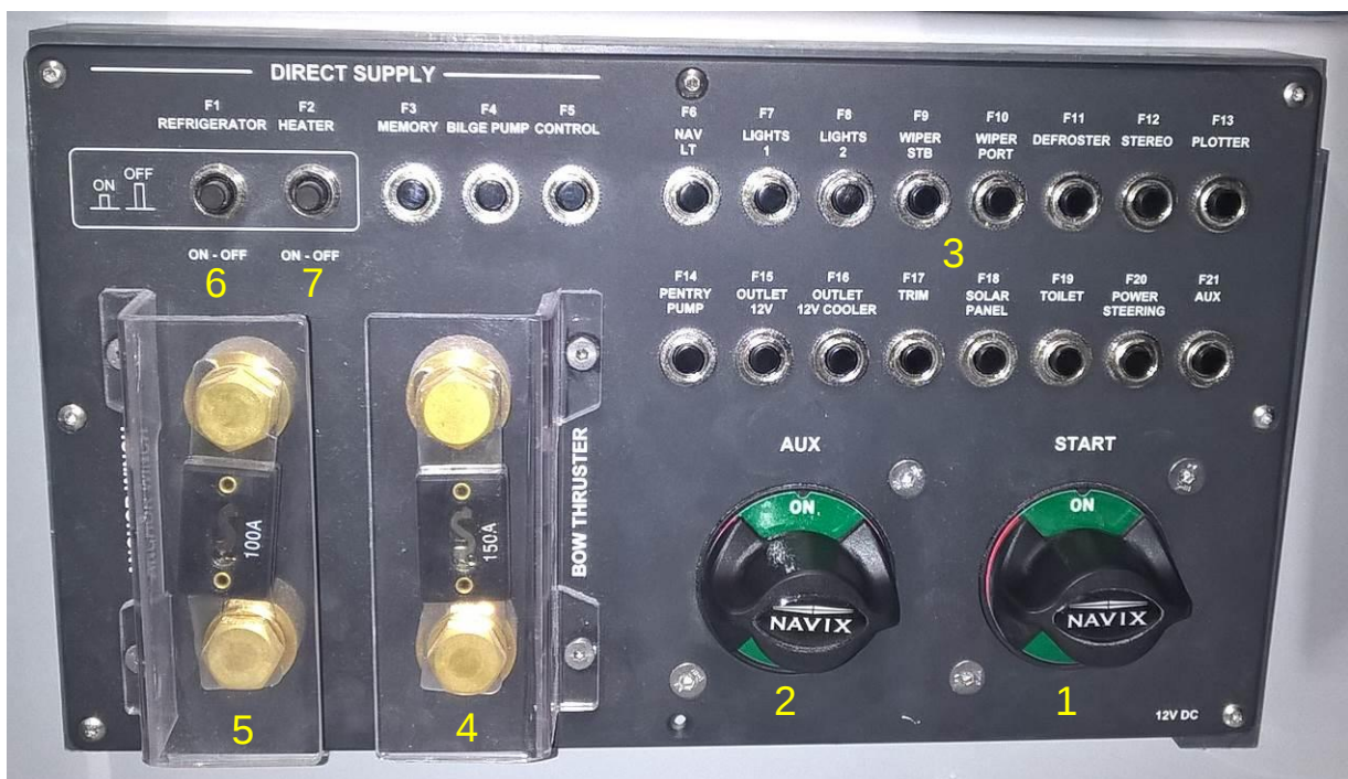
Kuva: Pääkytkimet ja sulakkeet
